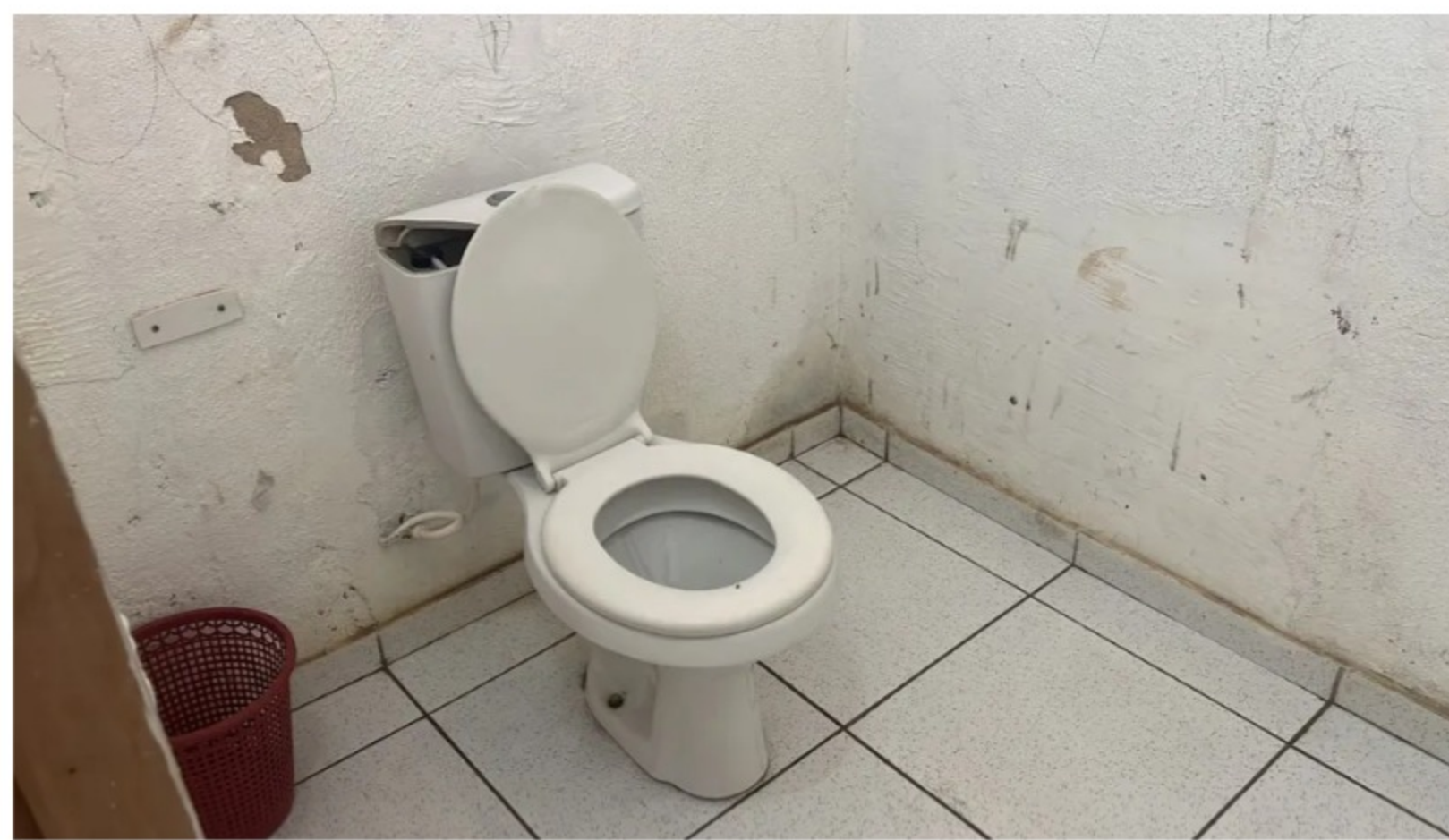
Vaso sanitário quebrado, encontrado por fiscais em escola municipal, durante fiscalização no RN — Foto: TCE-RN/Cedida
