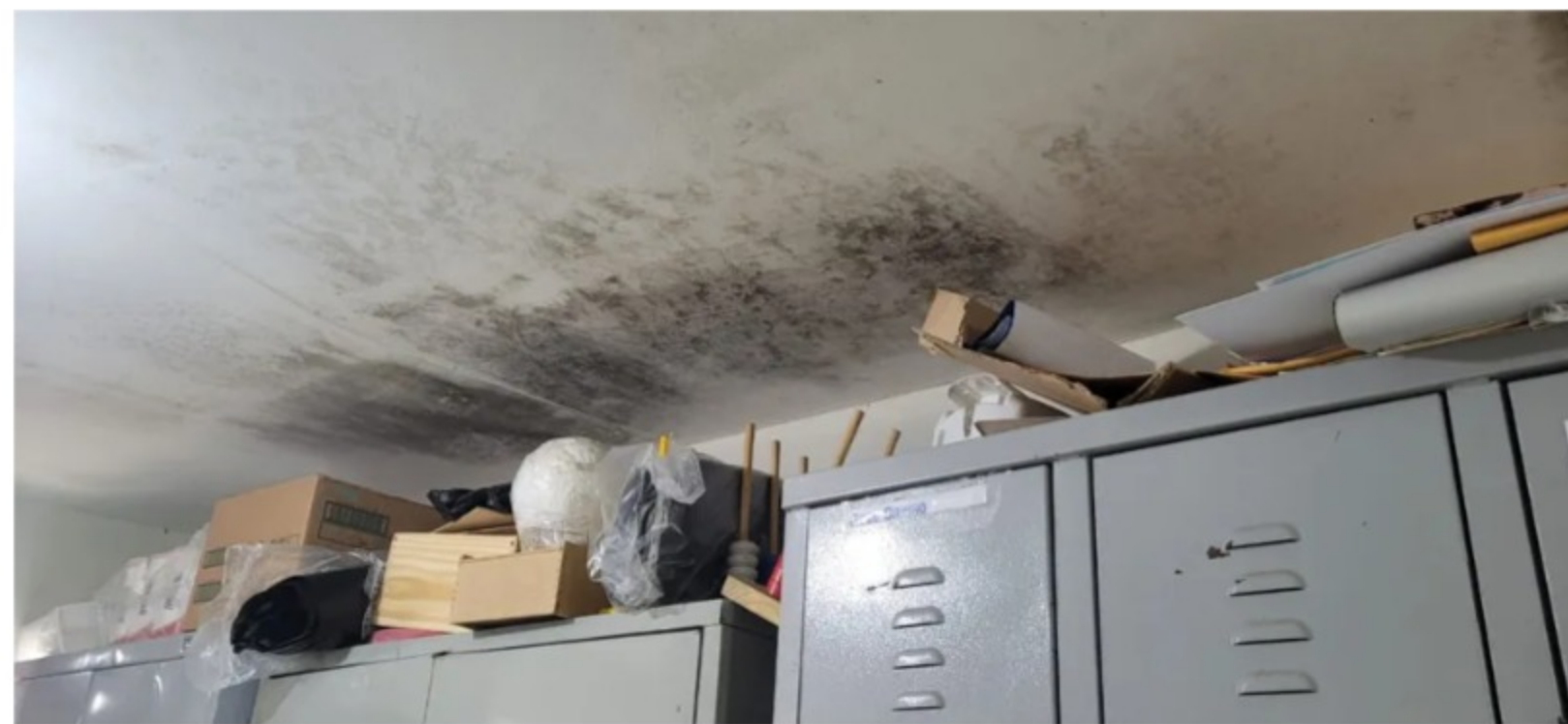
Mofo na sala de professores em escola do interior do RN. Imagem foi capturada durante fiscalização sobre infraestrutura das escolas. — Foto: TCE-RN/Divulgação
