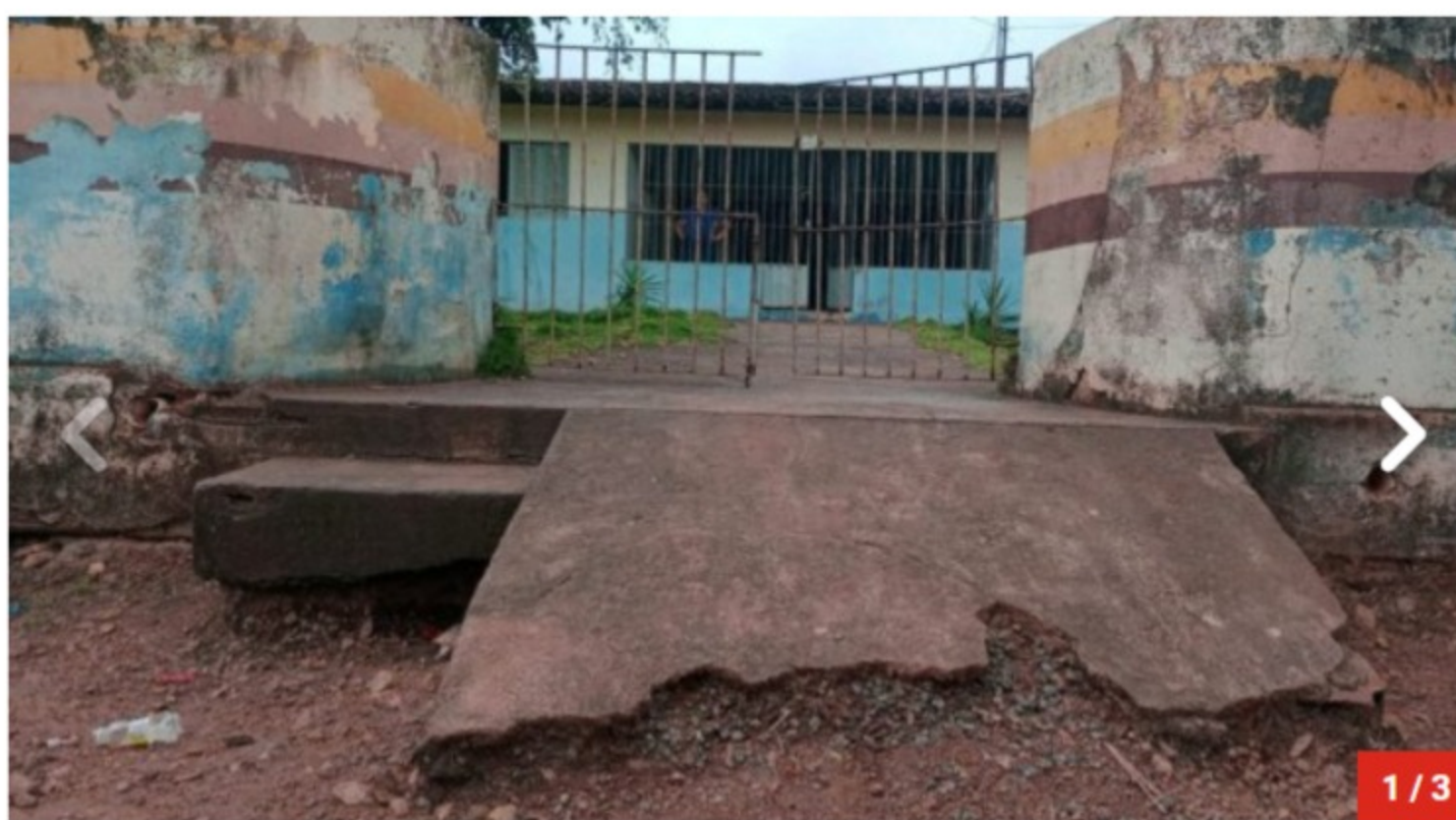
Rampa de acesso sem condições de uso na Escola Municipal Antônio Guedes Correia Gondim, em Itambé - DIVULGAÇÃO/TCE-PE
