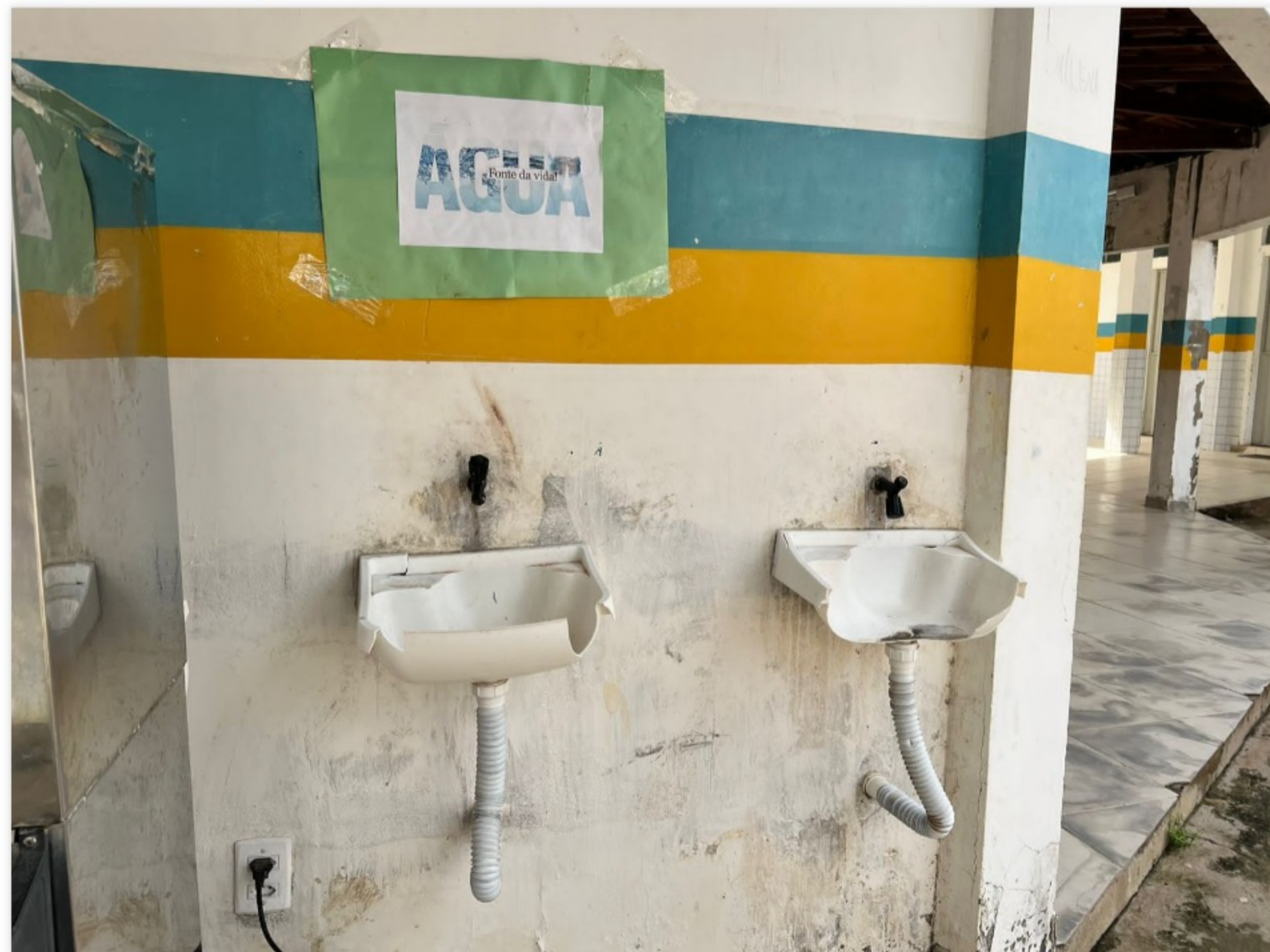
Em Orocó, Escola Quilombola Águas de Velho Chico - pias quebradas (Cortesia)
