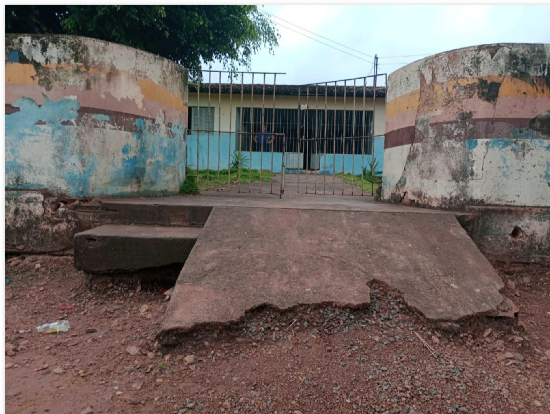
Em Itambé, Escola Municipal Antônio Guedes Correia Gondim, rampa de acesso sem condições de uso (Cortesia)
