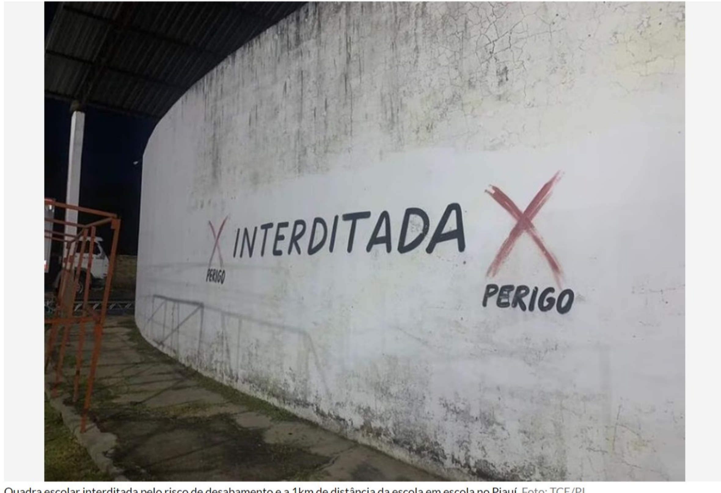
Quadra escolar interditada pelo risco de desabamento e a 1km de distância da escola em escola no Piauí. Foto: TCE/PI
