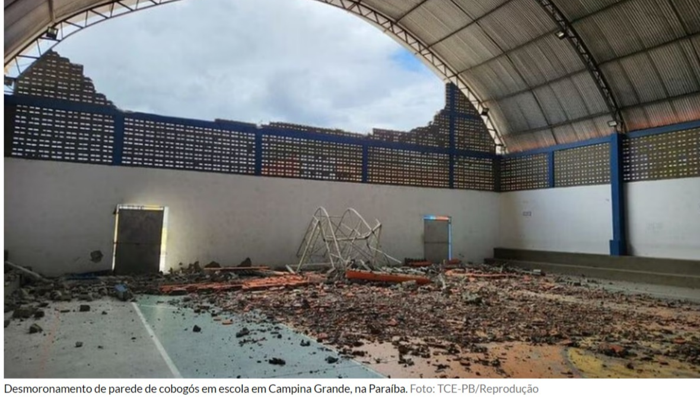
Desmoronamento de parede de cobogós em escola em Campina Grande, na Paraíba. Foto: TCE-PB/Reprodução
