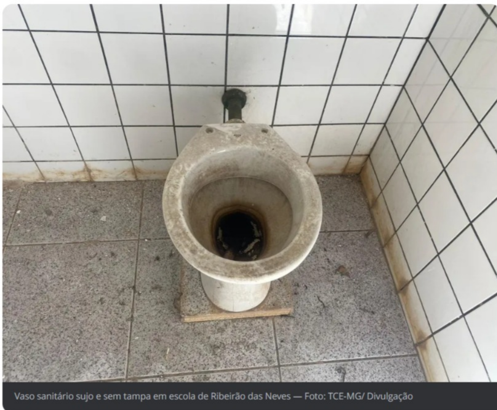
Vaso sanitário sujo e sem tampa em escola de Ribeirão das Neves — Foto: TCE-MG/ Divulgação
