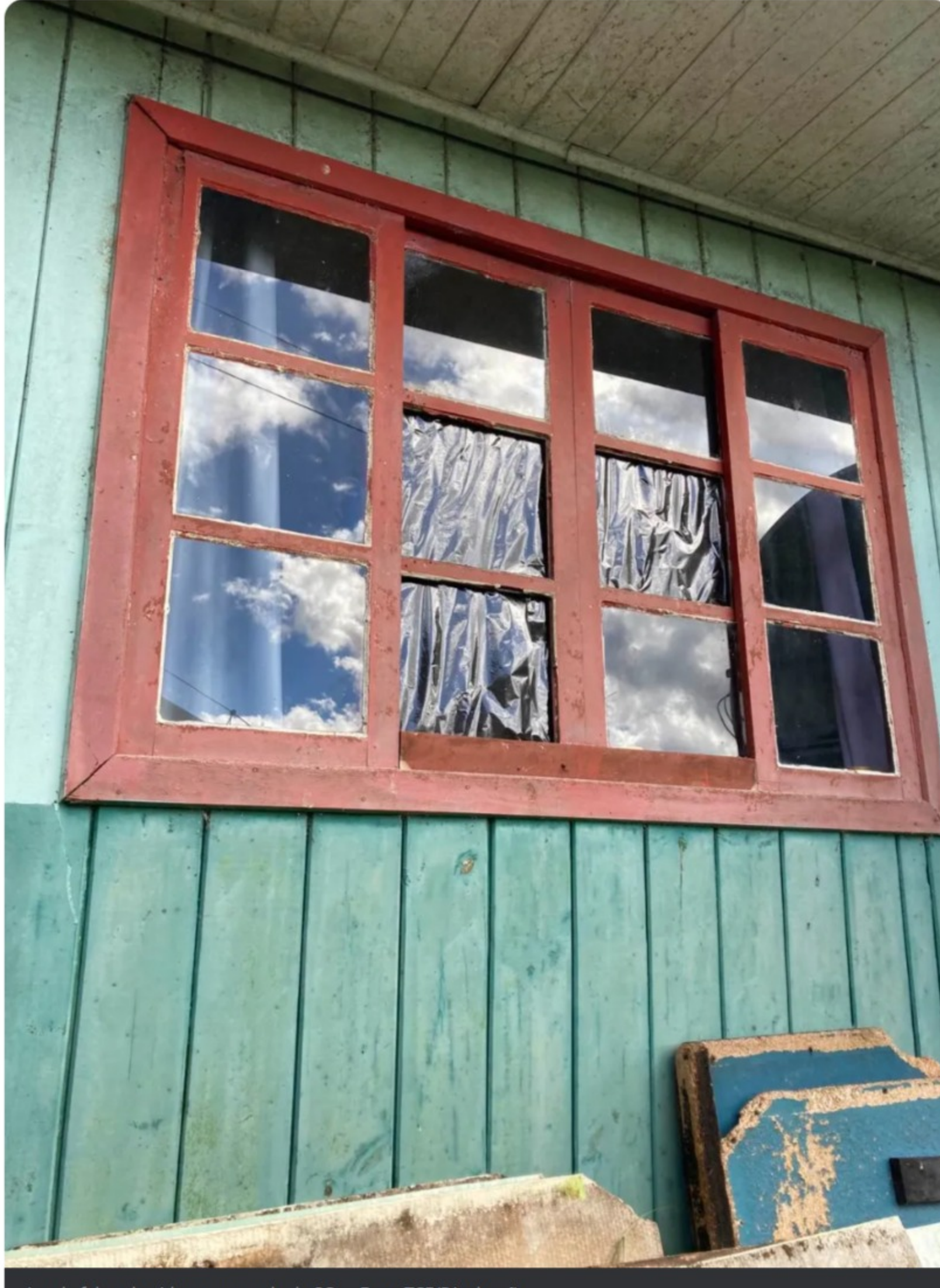
Janela faltando vidros em escola de SC — Foto: TCE/Divulgação
