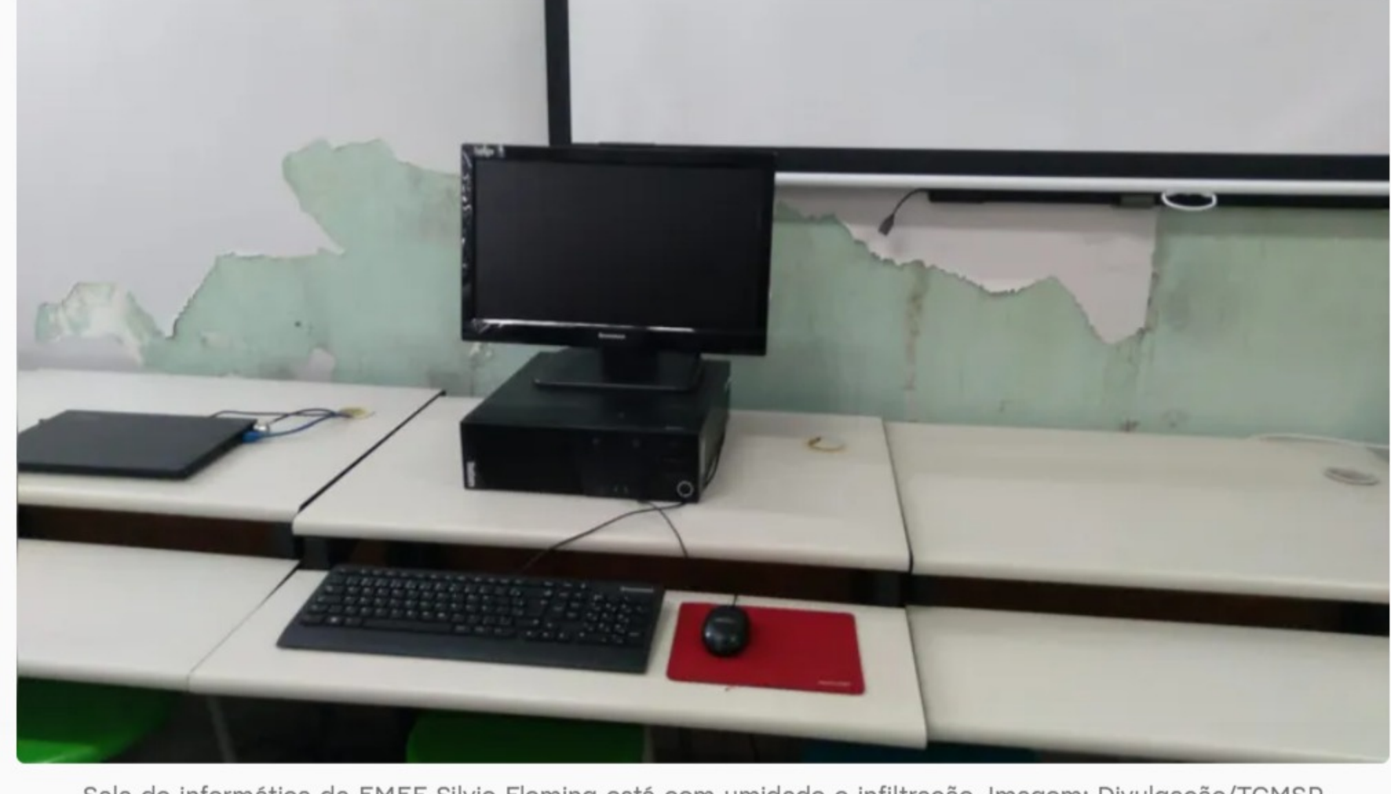
Sala de Informática da EMEF Silvo Fleming está com umidade e infiltração. Imagem: Divulgação/TCMSP
