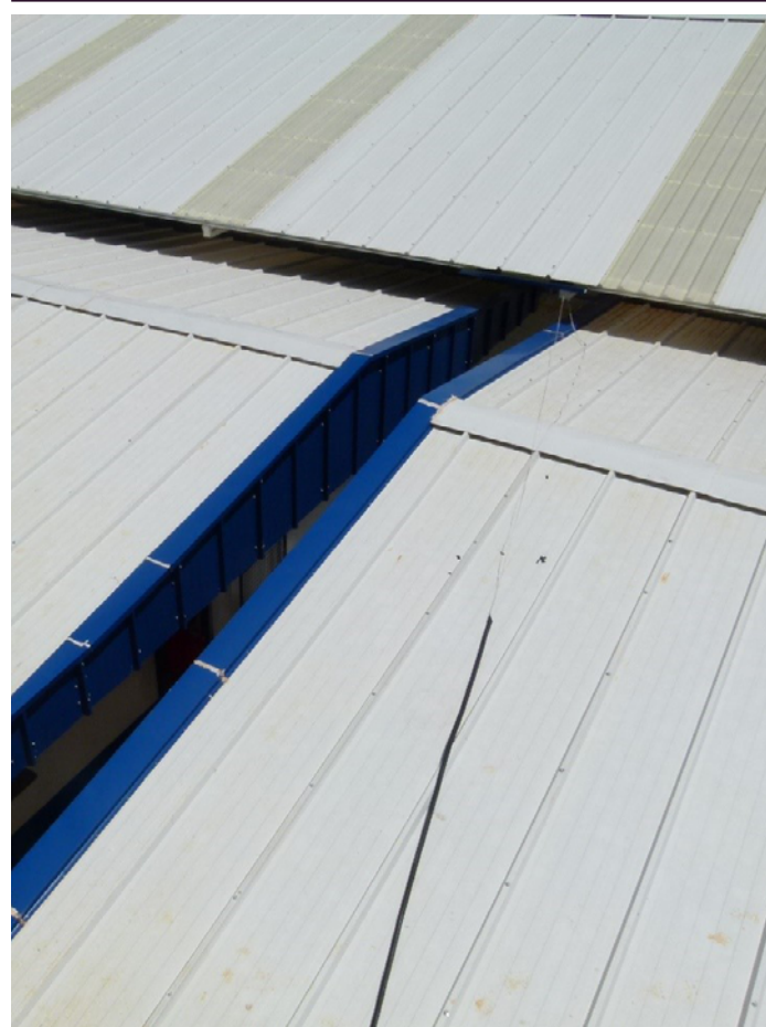
Figura 26. Cabo desprotegido em obra em Anápolis (GO)
