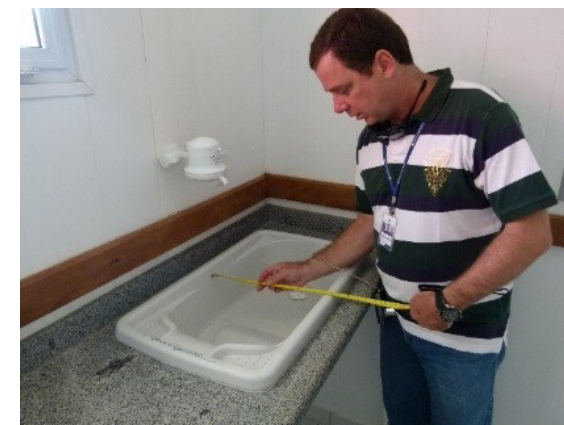
Figura 24. Defeitos constatados na obra em Anápolis (GO)
