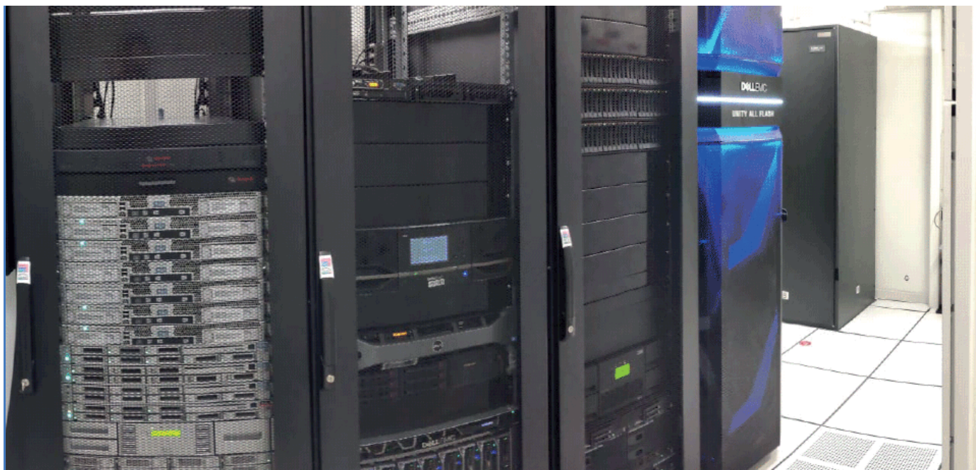
Data center TCE-MS
