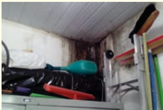
Lousa com bolor e infiltrações
