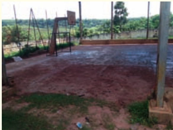
Quadra poliesportiva em condições precárias
